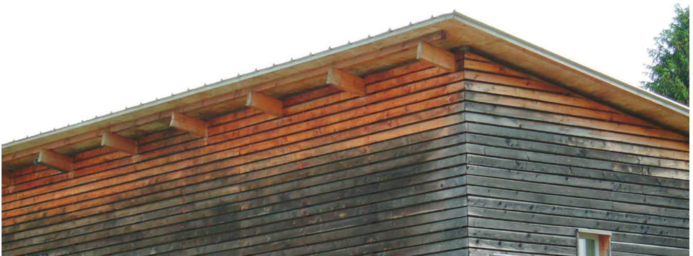
Unbehandelte Lärche witterungsbedingt verschieden vergraut (unter Dachüberstand und auf freier Fassadenfläche)
